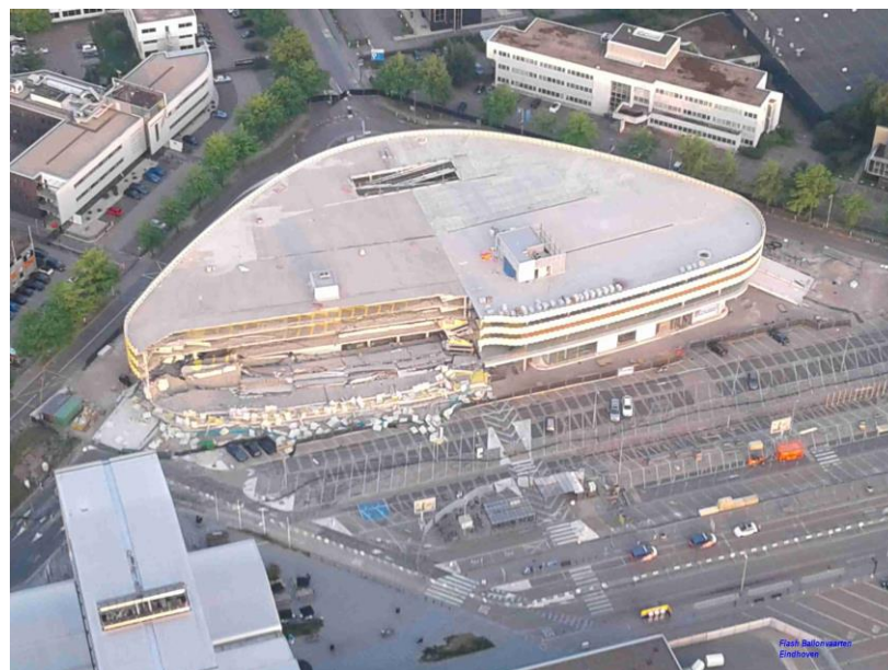
Figuur 3.2: Overzicht van het MPB na de gedeeltelijke instorting (foto Flash Ballonvaarten)
