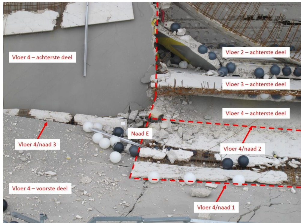
Foto A.23: Overzicht van het ingestorte deel ter plaatse van naad E
