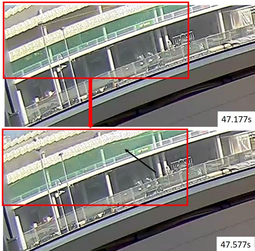
Figuur 4.14: Vloer 3 en 4 verplaatsen naar achteren; vloer 2 draait achter de kolommen omlaag; buitenrand draait daarbij omhoog; in vloer 2 ontstaat een breukvlak ter plaatse van naad A (zwarte pijl); kolommen zijn nog niet bezwaken (bovenste beeld is op 47.177s; onderste beeld op 47.577s) [55]
