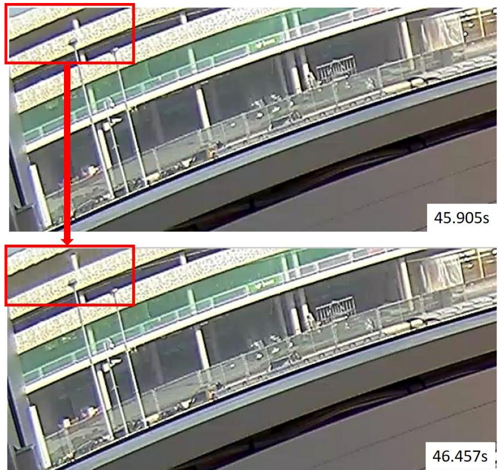
Figuur 4.12: Vloer 4 draait achter de kolommen omlaag; buitenrand draait daarbij omhoog; kolommen zijn nog niet bezwaken (bovenste beeld is op 45.905s; onderste beeld op 46.457s) [55]
